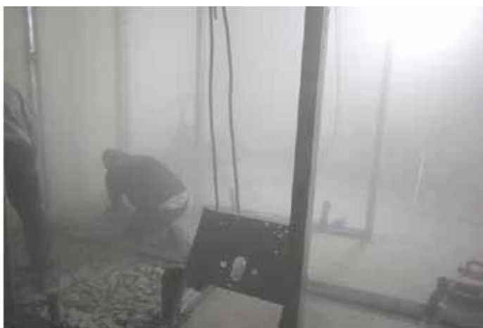
Likaantunut ilma betonilattian veistämisen ja leikkaamisen jälkeen.
